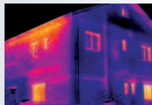
Выявление энергетических потерь в зданиях: Моментальное обнаружение и фиксация тепловых мостиков на фасадах или в ограждающих конструкциях зданий
